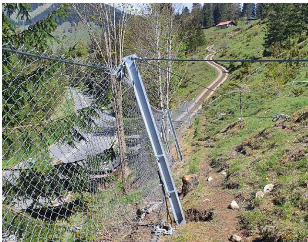
Figure 11 : Filet pare-pierres 100 kJ (type Geobrigg® GBE-100A – Photo www.geobrigg.com ). Ouvrages proposés dans les secteurs Trois-Villes et Cochâble I et II.
