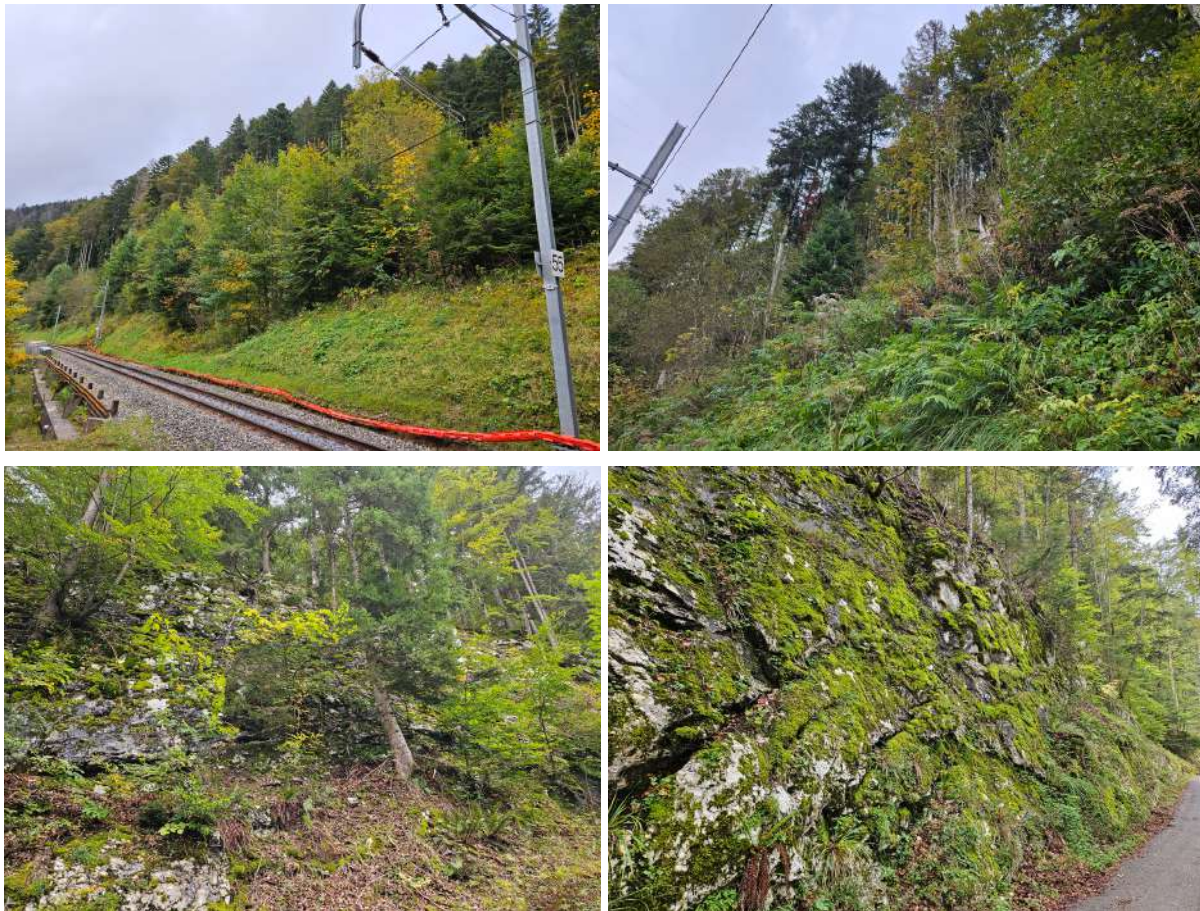
Figure 6-13 : Photos du secteur 5 "Les Recolas". En haut, photos des secteurs de pose de treillis, en bas photos de la falaise.
